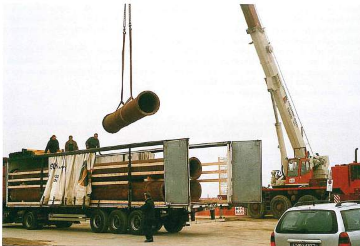
Figura 7 - Riccione: operazione di scarico dei tubi trasportati via terra dal nord Europa.
