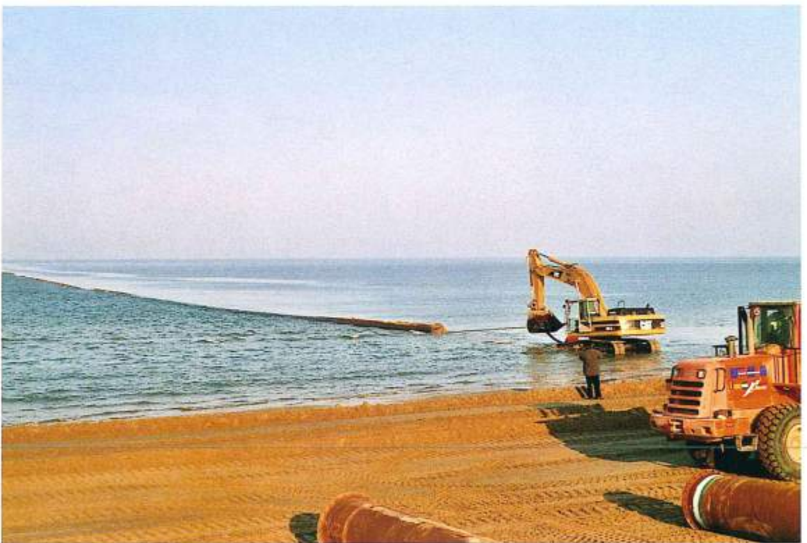
Figura 10 - In alto: tubazione in galleggiamento manovrata da un mezzo navale durante la fase di avvicinamento alla spiaggia; in basso: la stessa tubazione viene agganciata da una pala meccanica per essere tirata sulla spiaggia.
