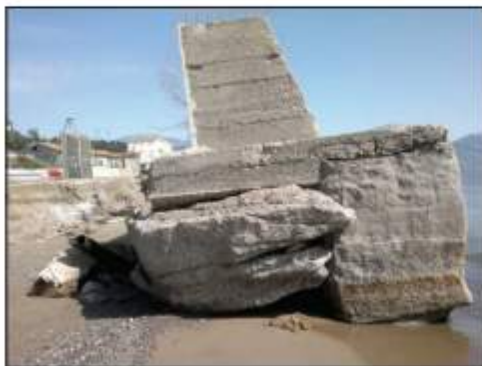
Figura 10 - Terrapieno in cemento armato costruito sul litorale di Capitello (SA) in una foto del 2012. La struttura, a causa della mancanza di manutenzione, sta pericolosamente cominciando a ribaltarsi creando un elevato pericolo per i bagnanti.
