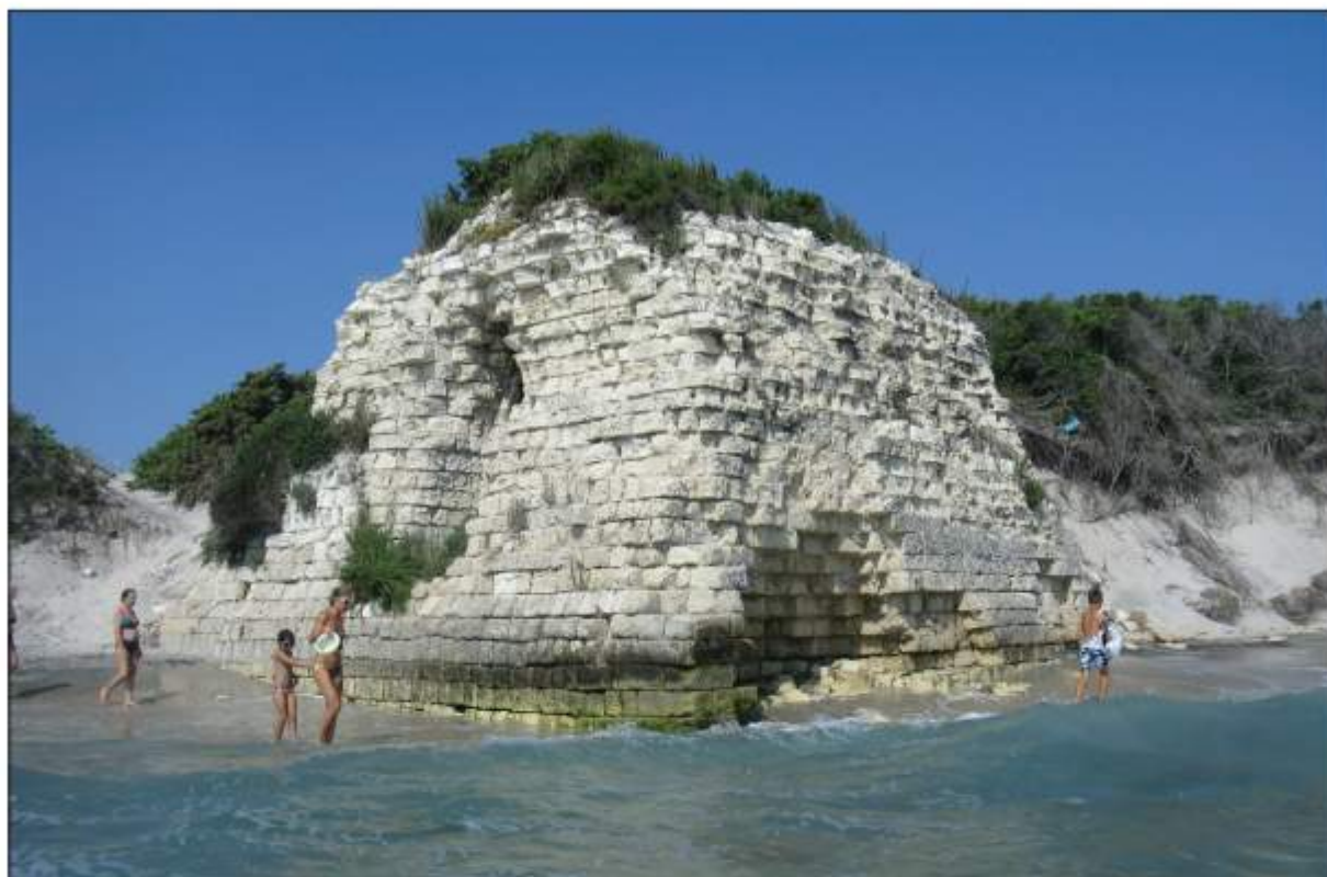
Figura 5 – Torre Fiumicelli conserva oggi solo il piano terra che ospita una cisterna voltata a botte. La torre si presenta ubicata in corrispondenza della battigia e con il piede sommerso dai sedimenti di spiaggia. Il moto ondoso ha raggiunto solo da qualche anno lo spigolo NE della torre a causa degli intensi fenomeni erosivi che stanno interessando il litorale. Una profonda nicchia erosiva minaccia oggi la stabilità della torre.
