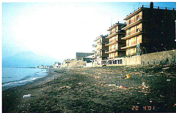
Figura 22 - La spiaggia del settore n. 3, che ha subito alterne fasi di erosione e progradazione e che, dopo la costruzione delle scogliere soffolte, mostra una tendenza all'avanzamento.
